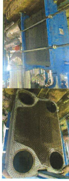
Figura 3. Dëmontimi/montimi i këmbysit të nxehtësisë 4 pas pastrimit kimik në termonënstacionin e Bregu i Diellit.
