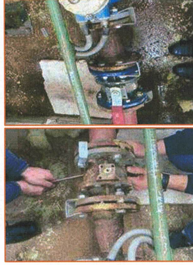
Figura 5. Ndririmi i valules DN 80, në stacionin kryesor Bregu i Diellit, a - valvula e vjetër DN80, b-valvola e ndrruar DN80.
